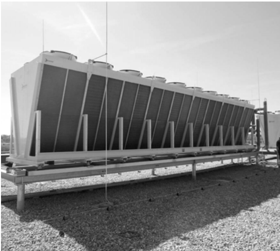
Abb. 2: Fangstange an einem auf dem Flachdach aufgestellten Rückkühler
