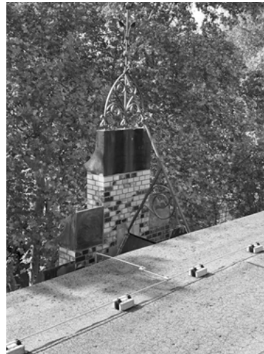
Abb. 3: Fangleitungen auf einem Flachdach
