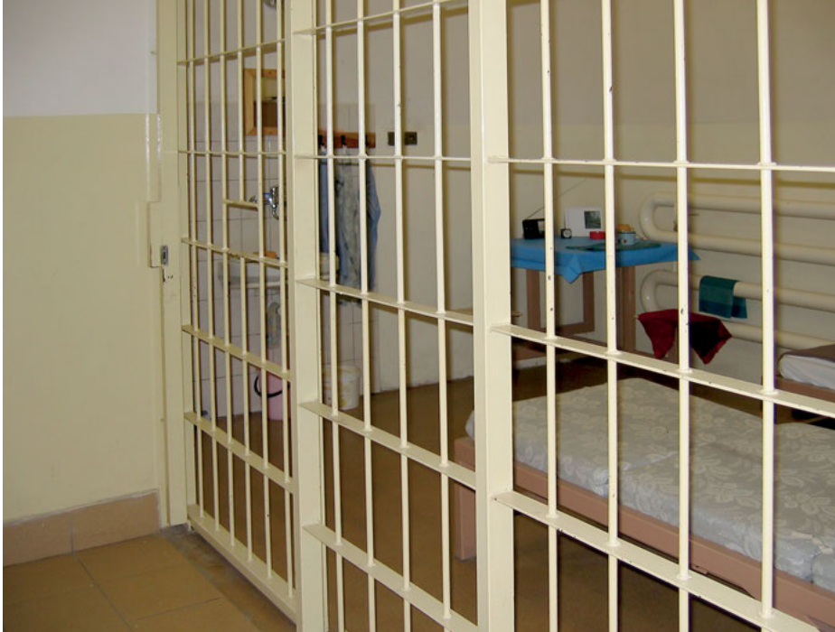
036 Gitter anstelle der vierten Wand
