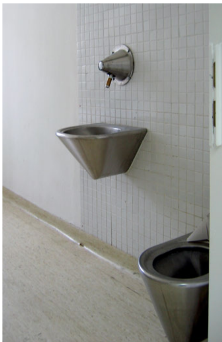
121 Anti Vandal Sanitäranlagen
