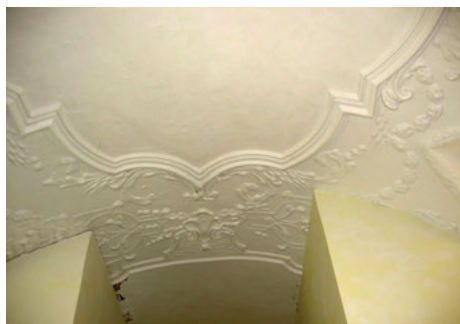
204 Durch Raumteilung beschädigt
