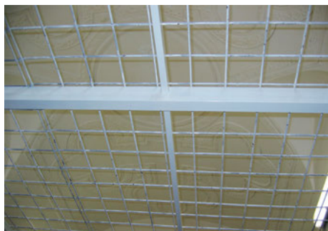
202 Barocker Deckenstuck vor den Insassen geschützt
