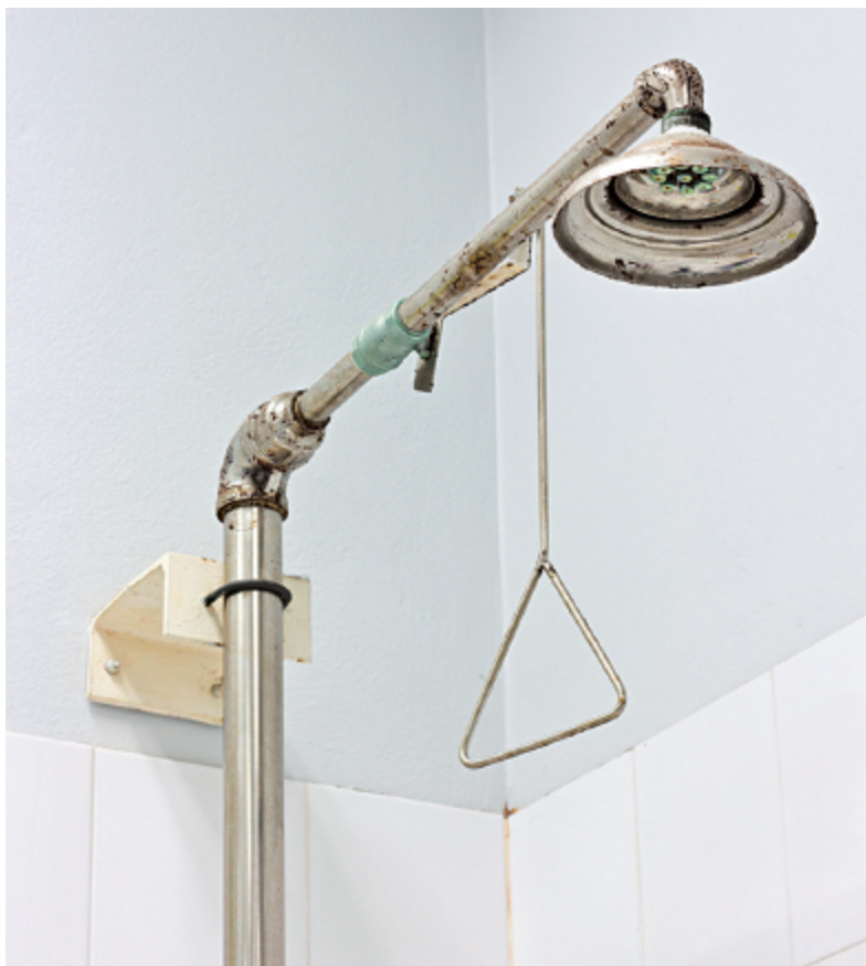
Figura 8.23 Chuveiro de emergência de parede.
